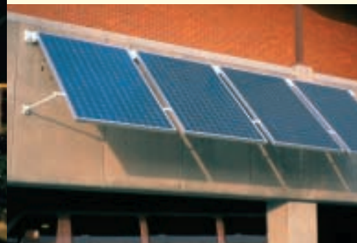
Typische Anbringung von Solarmodulen an Gebäuden.
