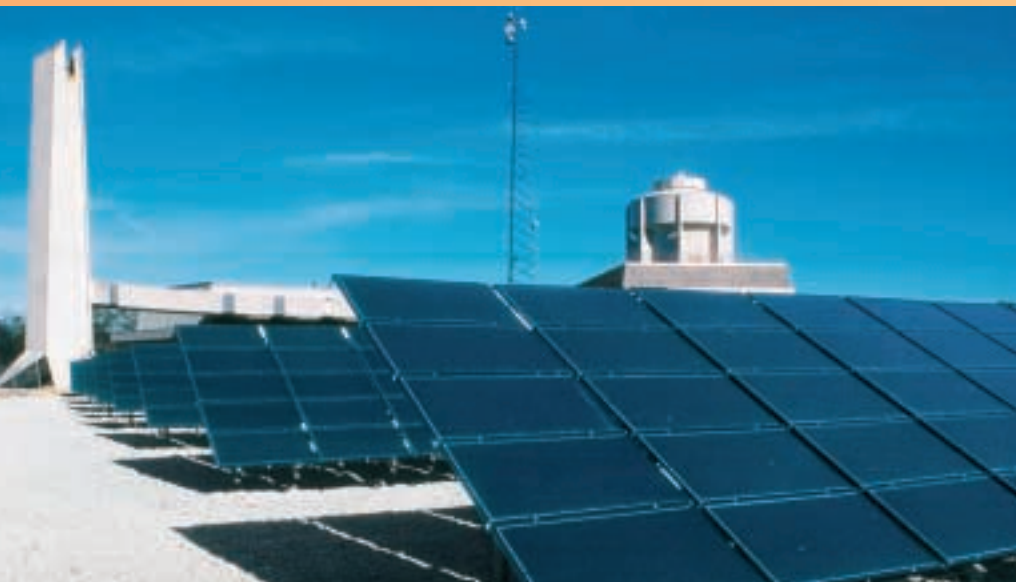
Bei Alliant Energy in Winnebago/Minnesota installierte netzgekoppelte Photovoltaik-Anlage. In Spitzenverbrauchszeiten können durch deren Einsatz Kapazitätsengpässe im Stromnetz überbrückt werden.
