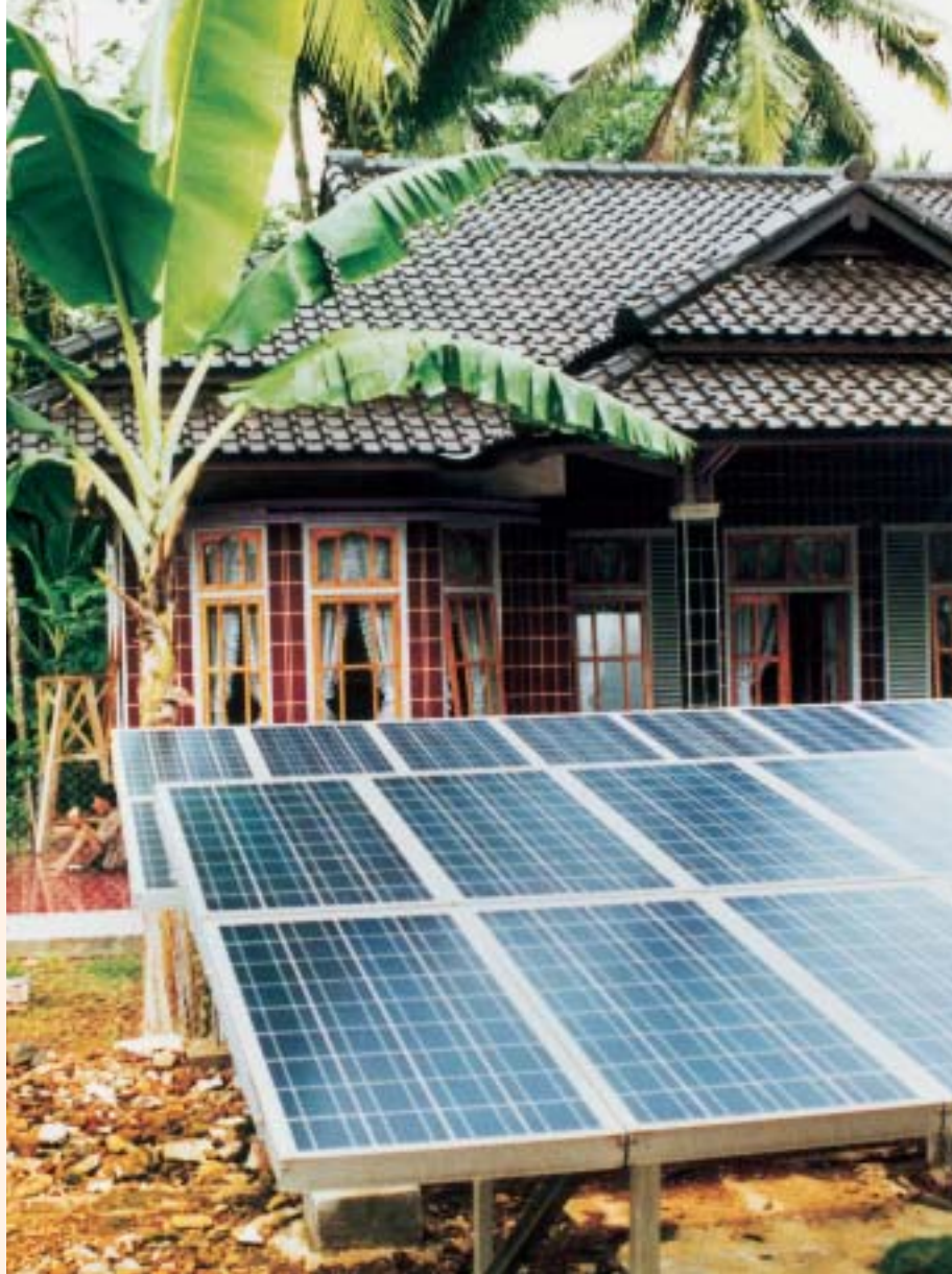
Ein großer Markt für Photovoltaik eröffnet sich in strukturschwachen Regionen. Solarstrom bietet hier die Möglichkeit der Versorgung mit Elektrizität für Licht, Kühlung und Kommunikation ohne die Umwelt zu belasten.
