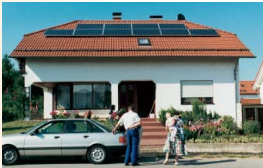
Photovoltaik-Anlagen auf dem Dach eines Einfamilienhauses. Der meiste Solarstrom wird erzeugt, wenn die Module nach Süden ausgerichtet und in einem Neigungswinkel von 30° angebracht sind.
