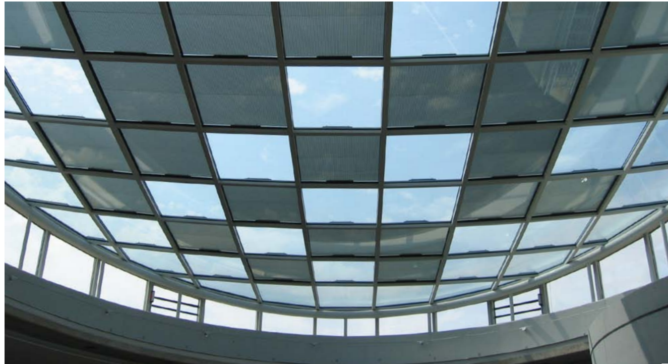
Luftige Eleganz: Teiltransparente Dünnschichtmodule schweben über der Pausenhalle der Grundschule München-Trudering.
